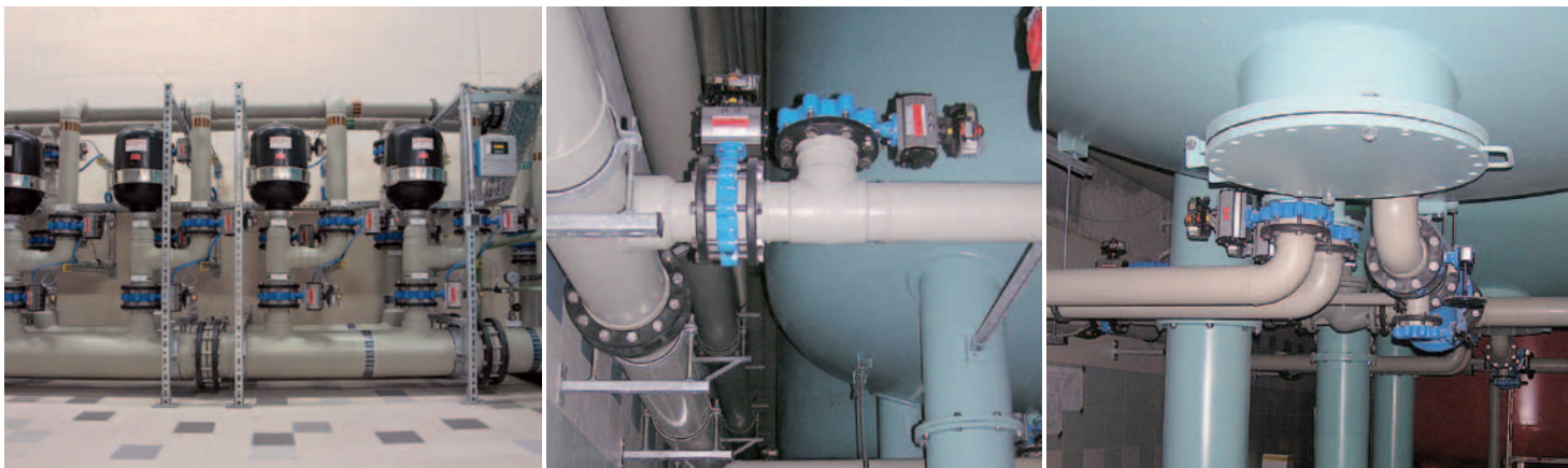
zleva: zařízení na filtraci surové vody; přemostění odbočkou; výtokové a regenerační vedení
